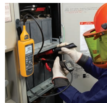
Pomiar impedancji z analizatorem akumulatorów Fluke BT521.
