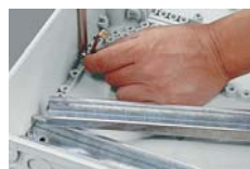
Montaż aparatury na szynie nośnej
