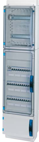
Rozdzielnicę rozbudowaną na wysokość
