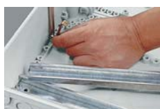
Montaż aparatury na szynie nośnej
