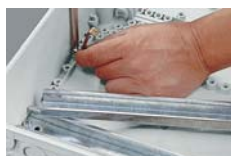
Montaż aparatury na szynie nośnej
