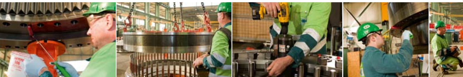
Główna jednostka napędowa maszyny do wiercenia tuneli składa się z czterech dużych przekładni, które są ze sobą sklejone i skręcone. Powierzchnie złącz kołnierzych są pokryte Loctite® 586 przy pomocy wałka, co zwiększa tarcie o 2 do 2,5 razy.
