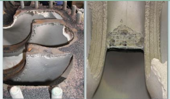
Wżery i ubytki w korpusie pompy
