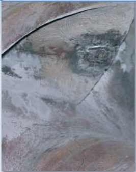
Wirnik i obudowa przed naprawą. Poważne zużycie i kawitacja na wirniku
