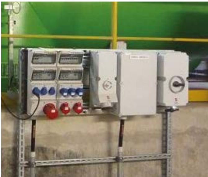
Salzgitter AG, Kraftwerk 4, Salzgitter, Deutschland
